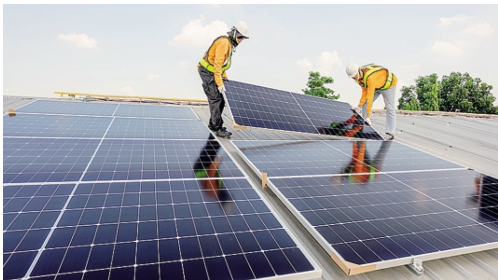
FOTOVOLTAICO I pannelli di nuova generazione consentono un incremento produttivo fino al 30%
